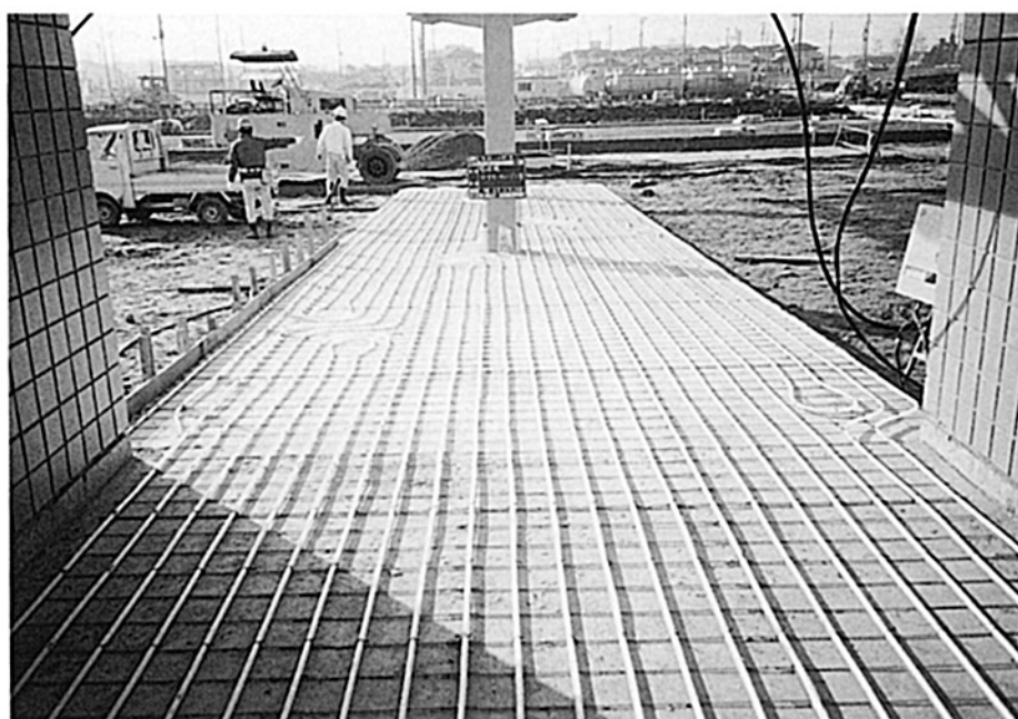
管理棟キャノピー ロードヒーティング配管
