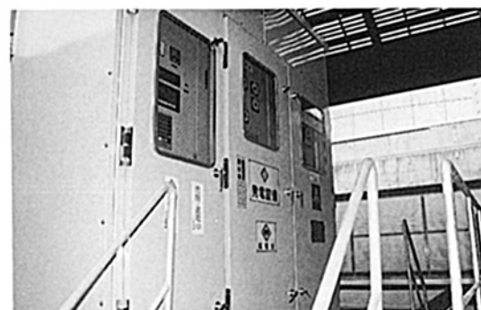
常用発電機操作盤
