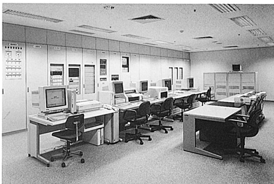
中央監視室 (エネルギーセンター)
