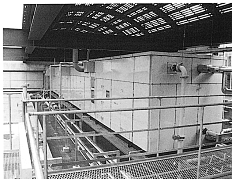
コ・ジェネレーションシステム 全ユニット
