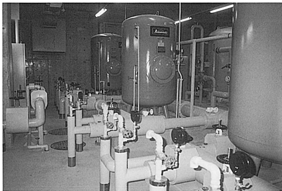
中水ポンプユニット
